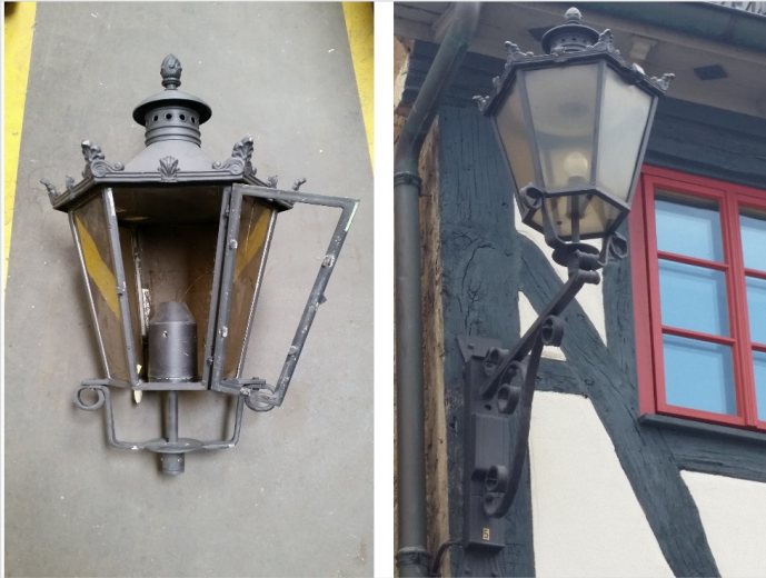
Vor der Umrüstung: desolater Zustand der bestehenden Leuchtenkörper
